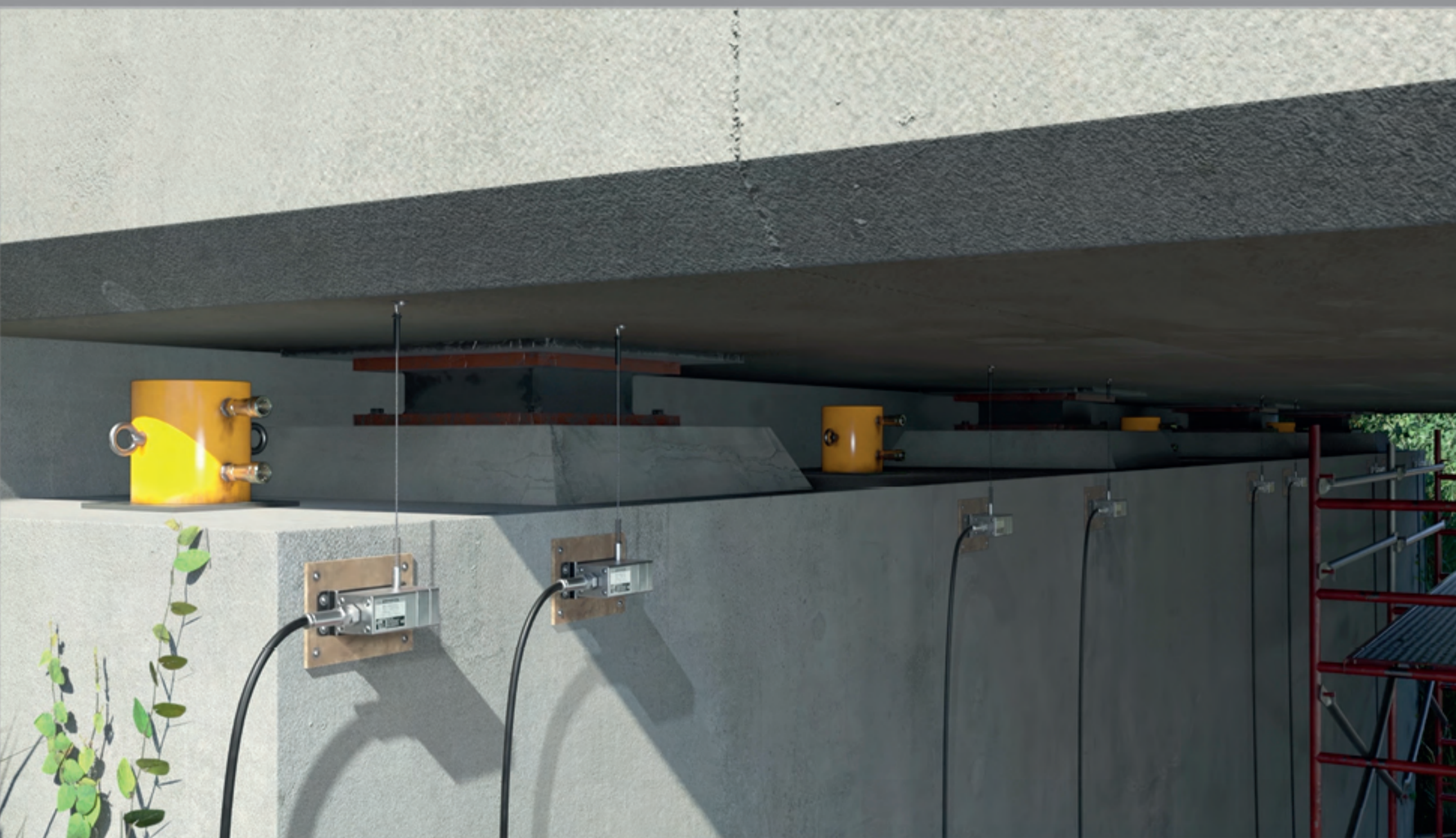
STEP 3 _ 거리측정센서 설치
